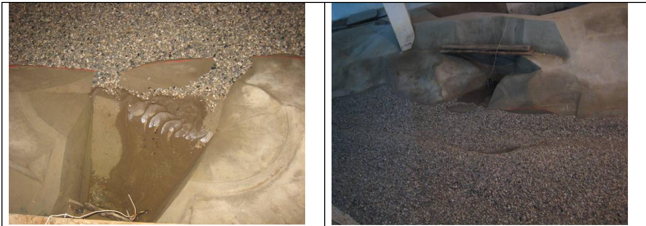
Hình 2: NMTĐ Huội Quang, bồi lắng cửa ra nhà máy (TNMHTL)
