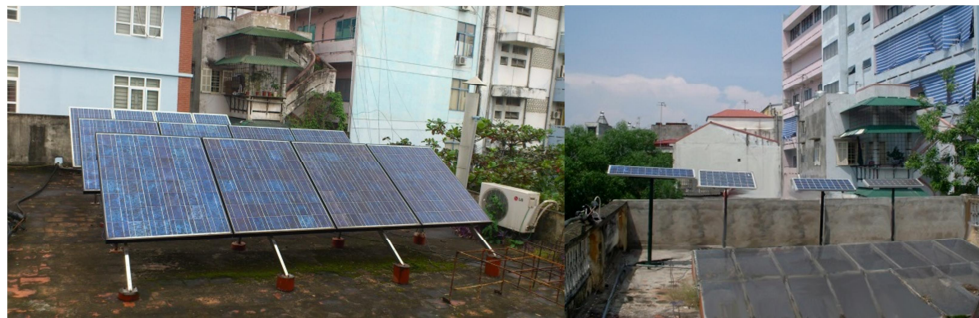
Trạm điện PMT nối lưới, Công suất 2,8kWp, tại Viện Năng Lượng-Hà Nội
