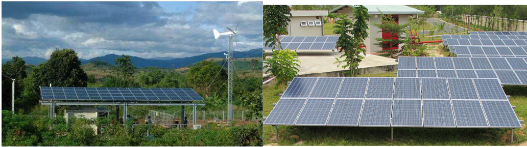
Trạm phát điện lai ghép PMT-Gió, Công suất 9kWp – Kon Tum
